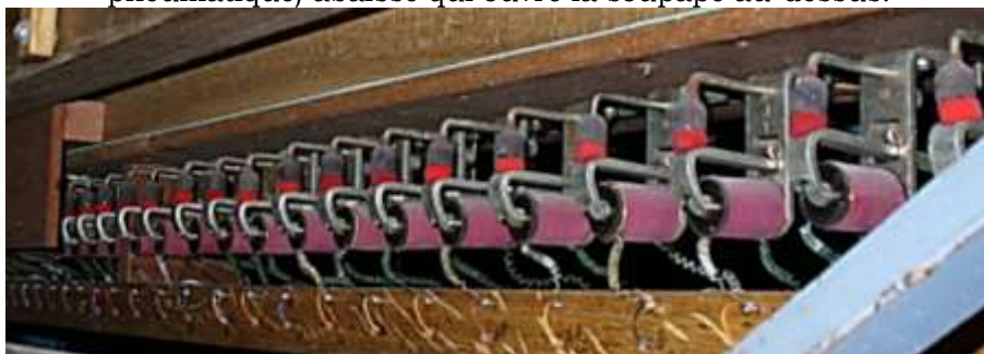
Rangée d'électroaimants qui commandent les moteurs pneumatiques
